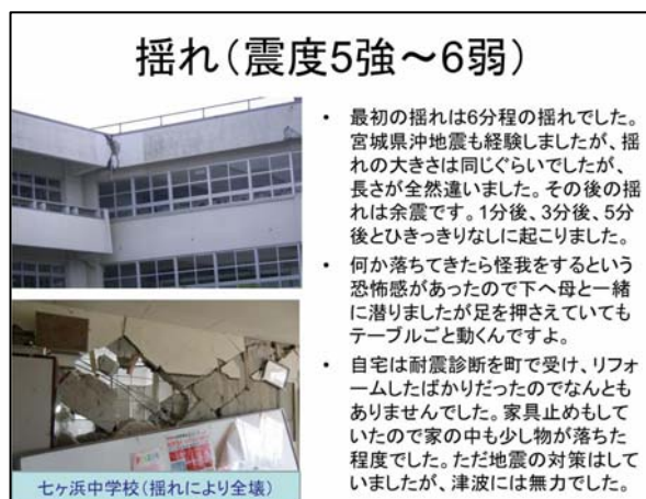
図9 東日本大震災での七ヶ浜町の地震による揺れの被害の様子
