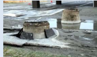
写真 マンホールの浮き上がり状況 (千葉県浦安市) [朝日新聞HPより]
