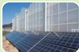
屋外太陽光パネル
