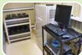
太陽電池蓄電システム
