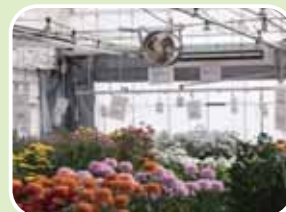
循環扇・ヒートポンプ (加温・冷房、循環)
