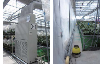
■ ヒートポンプ重油型の温湯管・加湿器
