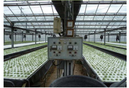
■ 培養液の制御盤
