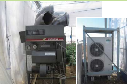
■ 加温設備(ヒートポンプ:温風)
