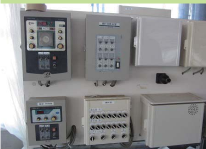
■ 加温設備の制御盤(ヒートポンプ)
