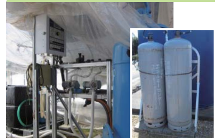
■ 給液の加温設備(熱源はLPガス)
