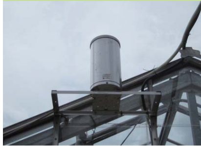
■ 雨量センサーで天窓が自動開閉
