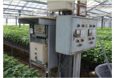
■ 加温設備の制御盤
