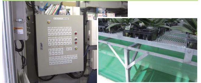
■ 送風機・循環扇/栽培棚下部からの送風
