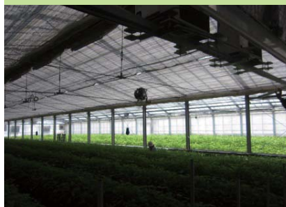
■ ヒートポンプと循環扇
