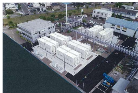
図5 サーラ浜松蓄電所
